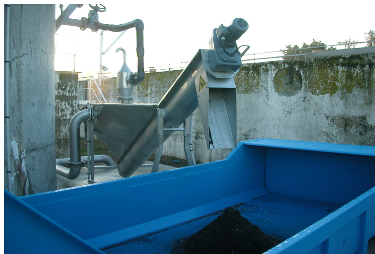
Installation en extérieur
