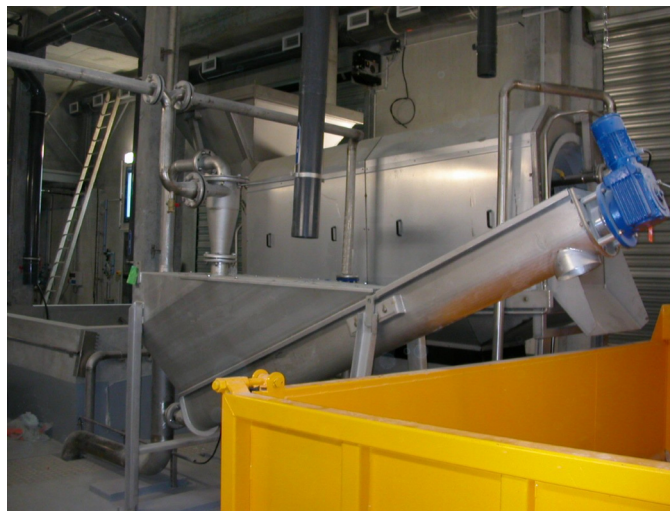
Installation en intérieur
